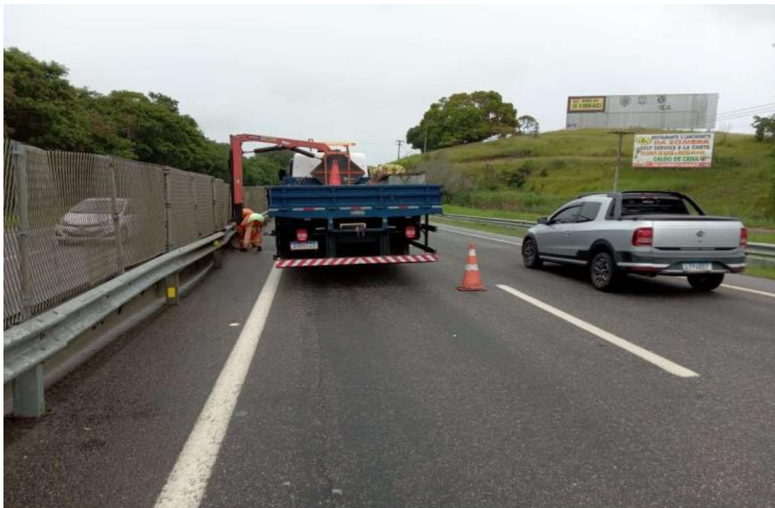
FOTO 04 – Dispositivo de Segurança – Km 10+600 Norte
